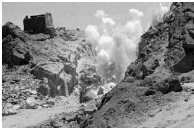
Explosion à la dynamite lors de la construction de la route 5, entre Barquito et Chañaral, région d'Atacama, Chili
